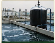
STP / ETP + MBBR
